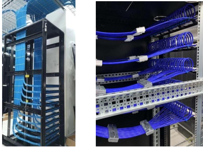
图 3 综合布线系统机柜内理线工艺
